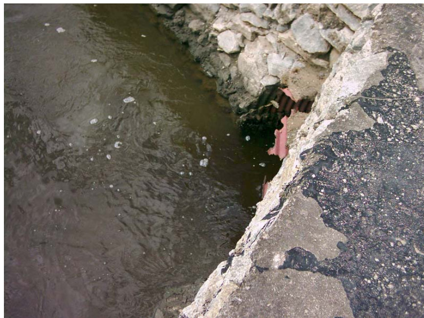
Foto 69: Bueiro sob a RJ 104 que interliga o Canal da Marina ao sistema de canais de drenagem implantado na área brejosa onde se situa a atual lagoa de descarte
