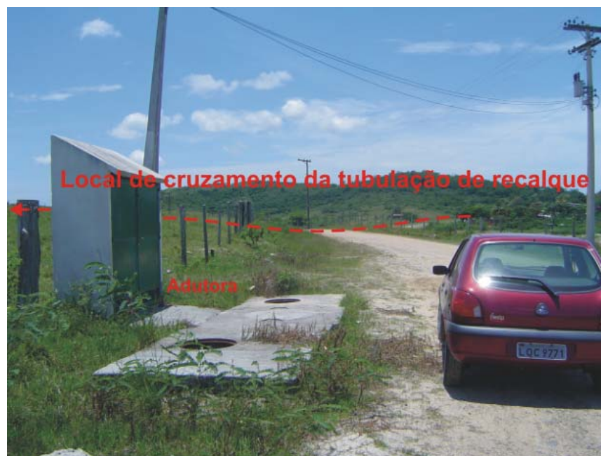
Foto 24: A tubulação de recalque atravessa a estrada e cruza com a adutora de água existente.
