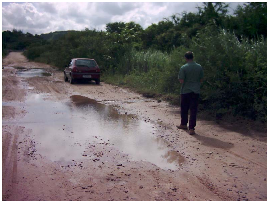
Foto 37: Estrada que corta a drenagem. Nota-se as poças formadas pela chuva.
