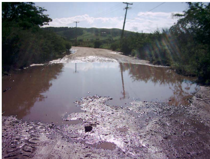
Foto 44: Alagamento formado pelo extravasamento do brejo, em função do estrangulamento no encaminhamento da drenagem natural.
